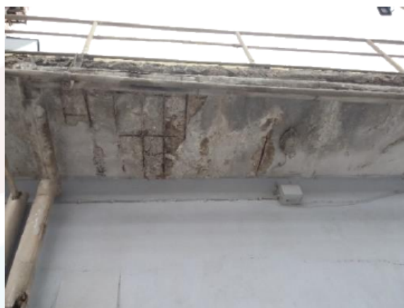
Figura 1: Elemento de concreto armado afectado por ataques de cloruros y sulfatos.
